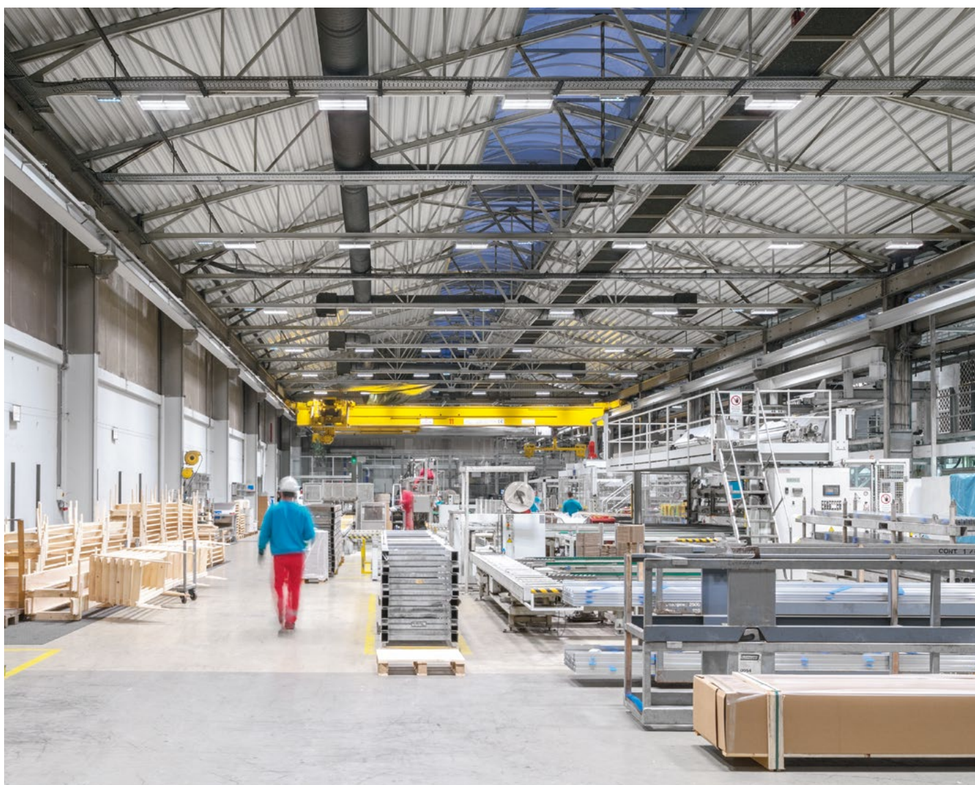
Sapa Extrusion Nenzing GmbH, Nenzing | AT Proyectista eléctrico: EGD Installations GmbH, Dornbirn | AT Solución de iluminación LED: Luminaria LED CRAFT para naves
