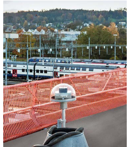
Der Tageslichtmesskopf auf dem Dach der SBB Serviceanlage in Oberwinterthur. Bei dem Zumtobel-System braucht es keine weiteren Kontrollsensoren in der Halle für die tageslichtabhängige Lichtsteuerung.
